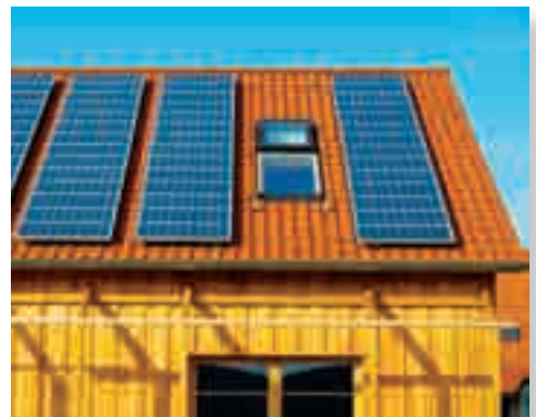
En el techo de esta casa hay celdas solares que producen electricidad. Unas baterías almacenan parte de esa electricidad para usarla en los días nublados o durante la noche. Esta casa, además, tiene claraboyas que dejan entrar luz en las habitaciones que, de otro modo, estarían a oscuras.
